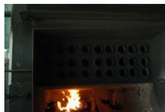
Foyer de chaudière à biomasse
