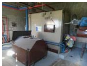
Une chaudière à biomasse
